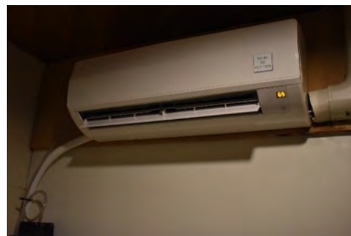
Figure 21 Mini split indoor unit
