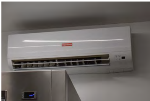
Figure 20 Mini split indoor unit
